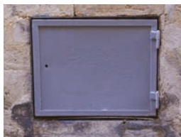
▮ Porte métallique devant le robinet de coupure de l'eau.
