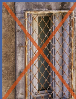
➔ Grille rectangulaire à motifs décoratifs inadaptée sur l'ouverture cintrée.
