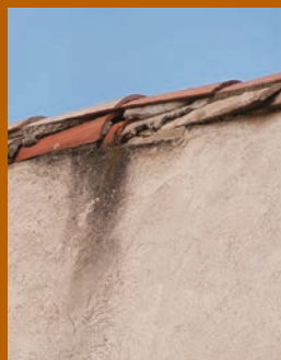
! Infiltration au niveau de la rive d’une toiture engendrant la dégradation du mur.
