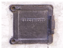
▮ Porte métallique devant le raccordement à l'électricité.
