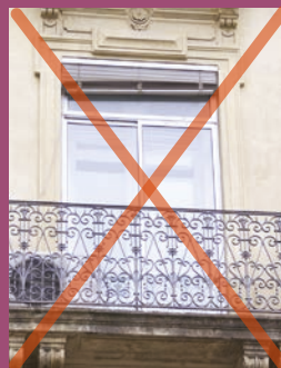
⊖ Les doubles fenêtres extérieures sont interdites.
