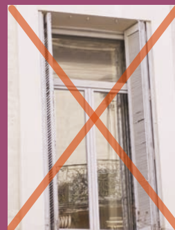
⊖ Le montant central de l'imposte a été supprimé.
