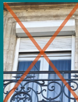
Le dépassement du coffre à l’extérieur favorise les entrées d’humidité.
