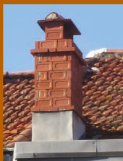
▮ Cheminée avec chaperon.
