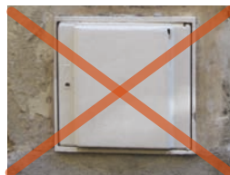
⊘ Coffret récent normalisé dépassant du nu extérieur de la façade.
