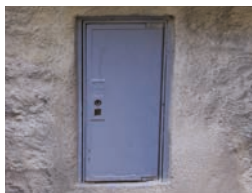
▮ Porte métallique devant le raccordement au gaz.
