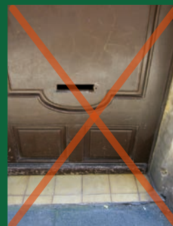
➔ Les seuils en carrelage sont interdits.
