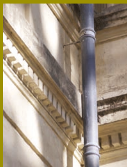
La descente en zinc est légèrement décollée de la façade, préservant ainsi les moulures.
