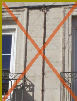
⊘ Seuls les câbles du réseau urbain sont autorisés en façade. L'alimentation de l'immeuble doit être supprimée.
