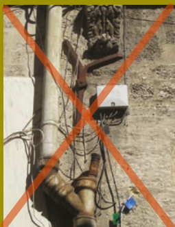
⊘ Les descentes d'eaux usées, les boîtiers, les fils pendants sont interdits sur les façades.
