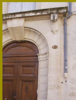
▮ Dauphin encastré en pied de mur et raccordé au réseau souterrain.
