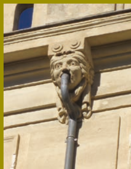
La descente d’eaux pluviales est branchée sur l’ancienne gargouille en pierre.
