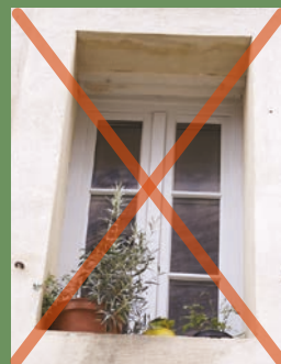
⊘ Pose en rénovation : les montants menuisés, très larges, réduisent la place des vitrages.
