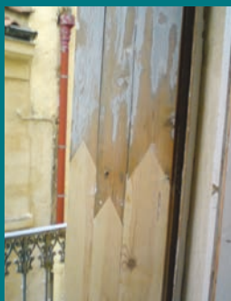
Volet ancien restauré : seul le bas a été remplacé.
