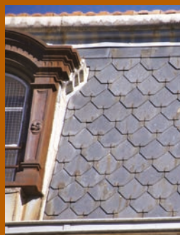
Le remplacement des crochets rouillés par des crochets inox permet de maintenir les ardoises.
