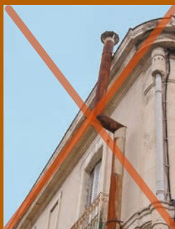
! Les conduits métalliques sont interdits.
